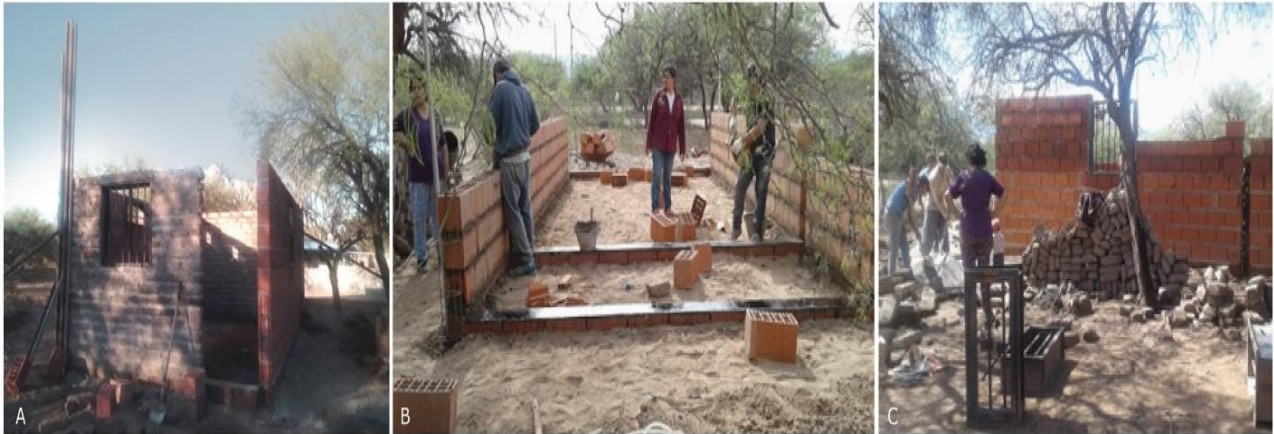
Figura 4 Resolución constructiva del frente (A), fundaciones y capa aisladora (B) y lateral con ladrillos y adobes (C)
